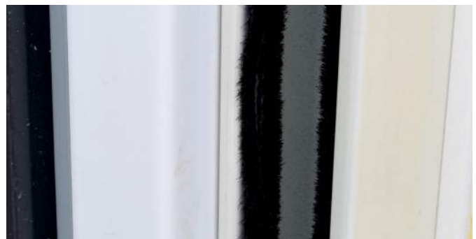
Abbildung 25: In Teilbereichen ist der Keder durchgescheuert und aufgespleißt.
