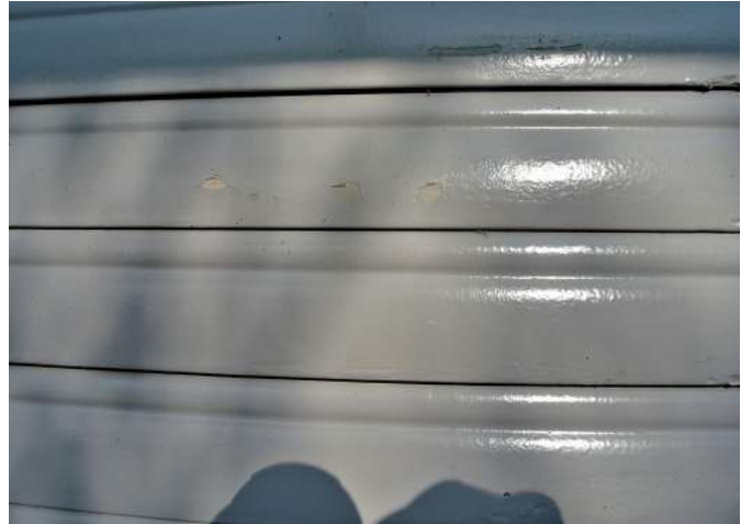
Abbildung 13: Fehlstellen in der Lackierung eines Holzrolllades.
