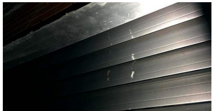
Abbildung 27: Klar zu erkennen sind hier tiefe Kratzer auf den obersten Stäben, die durch einen Grat o. Ä. verursacht wurden. Dies ist nicht zulässig.
