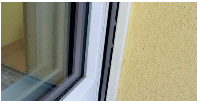
Abbildung 24: Der Keder ist teilweise so stark eingedrückt, dass er sich nicht mehr in seine ursprüngliche Form zurückstellt.
