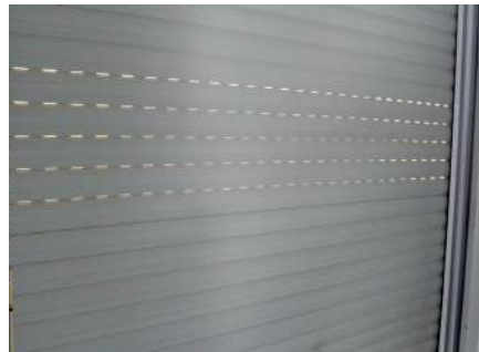
◀ Abbildung 17 + 18: Panzer mit offenen Lichtschlitzen im herabgelassenen Zustand. (Quelle: Hella)
